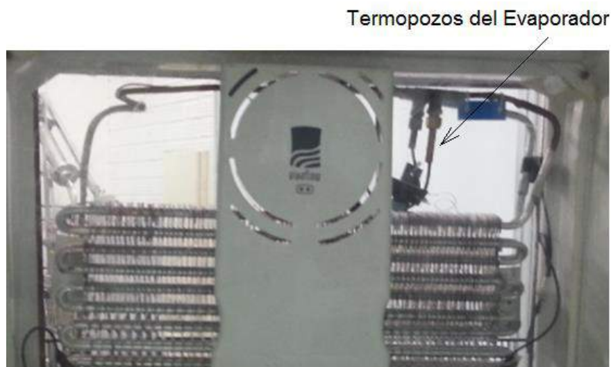
Figura 42. Termopozos para medición de temperatura en el evaporador. Hecha por los autores.
