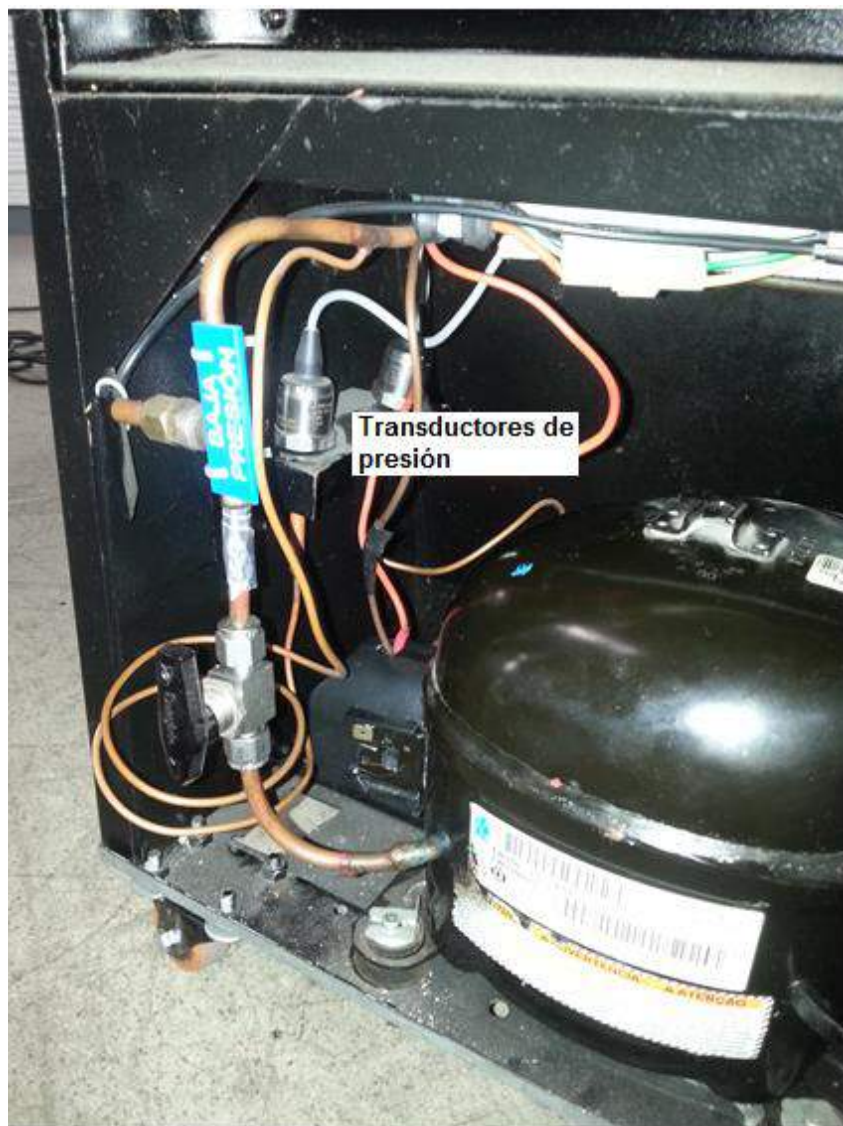
Figura 43. Ubicación de los transmisores de presión. Hecha por los autores.
