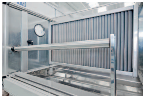
Figura 5: Tubo de vapor de humidificador isotérmico y eliminador de gotitas
