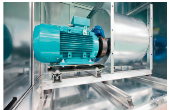
Figura 6: Primer plano del conjunto de ventilador y motor (motor excéntrico)
