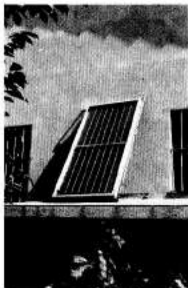
Fig. 1.— Colector apoyado en una pared del edificio.
