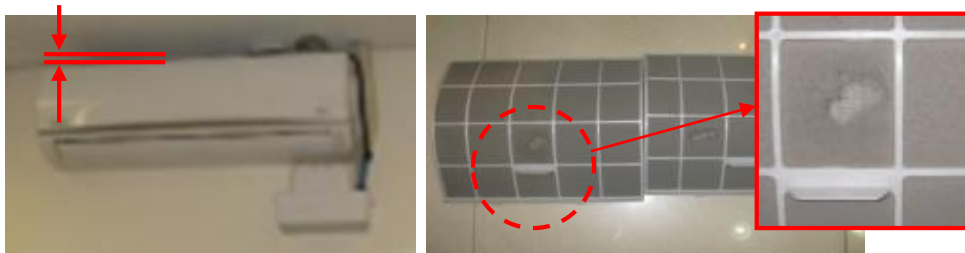
[Ingreso de aire limitado → temp. sube]
