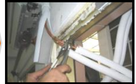
Conexion de Tuberias
