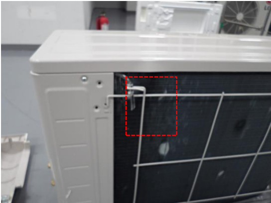
Compruebe la ubicación del sensor exterior
